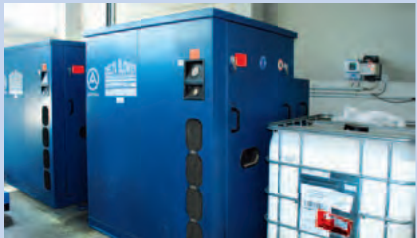
In der Gebläsehalle werden die verschlissenen Gebläse durch effizientere Technik ersetzt. Das spart Strom und senkt damit die Energiekosten.
